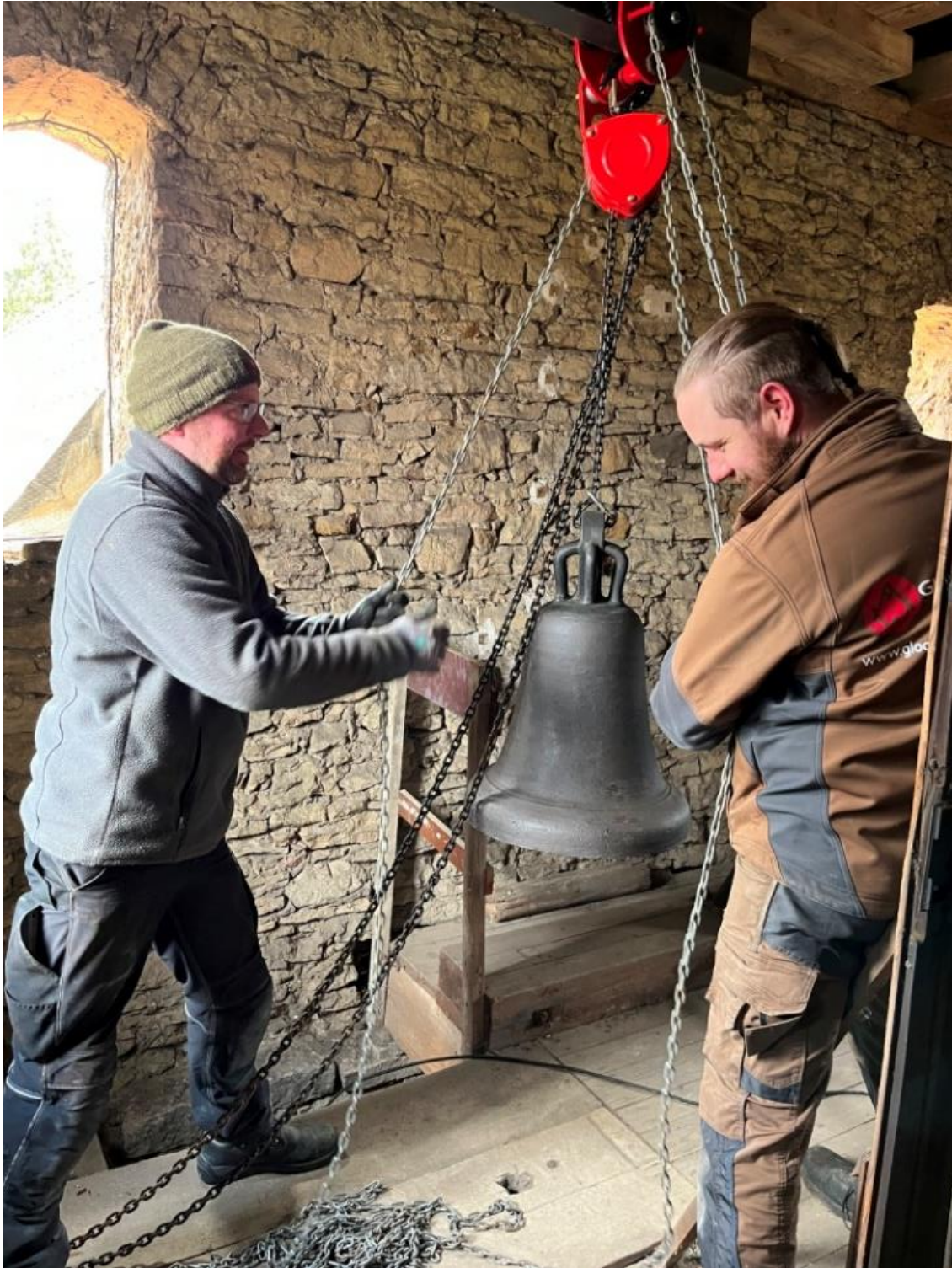
Bild 19: Im Turm übernimmt Eike Scherler (rechts) den Transport der Glocke an ihren endgültigen Standort. (Hier zusammen mit Malte Meiners, Fachwerk Kontor)
